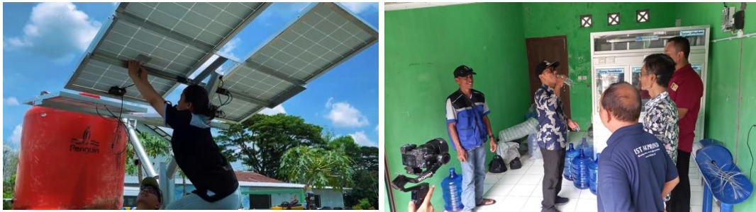
Gambar 1. Pemasangan Panel Surya (kiri), Instalasi Pengolahan Air bersih (kanan)
